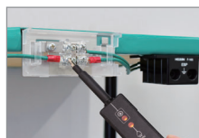
アース接続が集約され、 点検も容易にできます。
